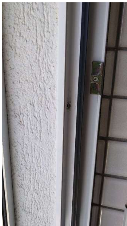
Pont thermique du cadre de la fenêtre
