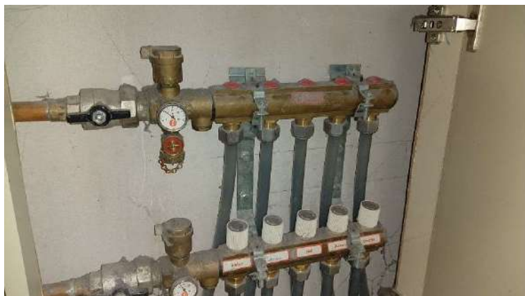
Collecteur de chauffage
