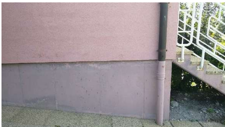
Pont thermique de la dalle de l'étage
