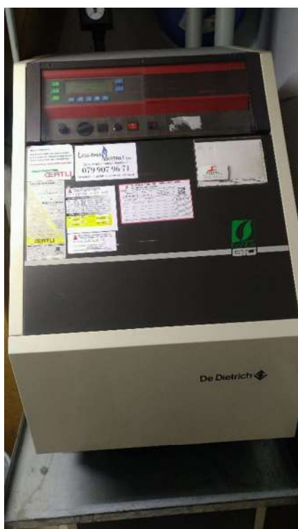
Chaudière à mazout
