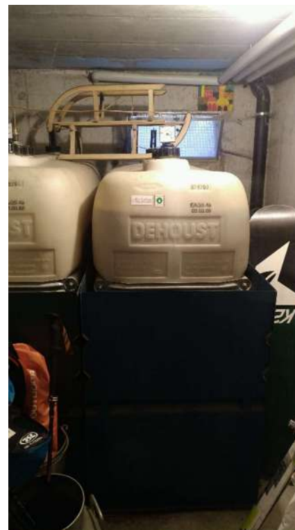
Citerne à mazout
