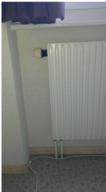
Radiateur avec vanne thermostatique
