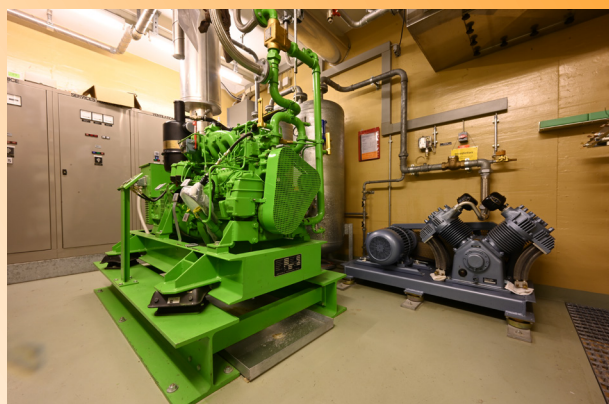
SALLE DES MACHINES
